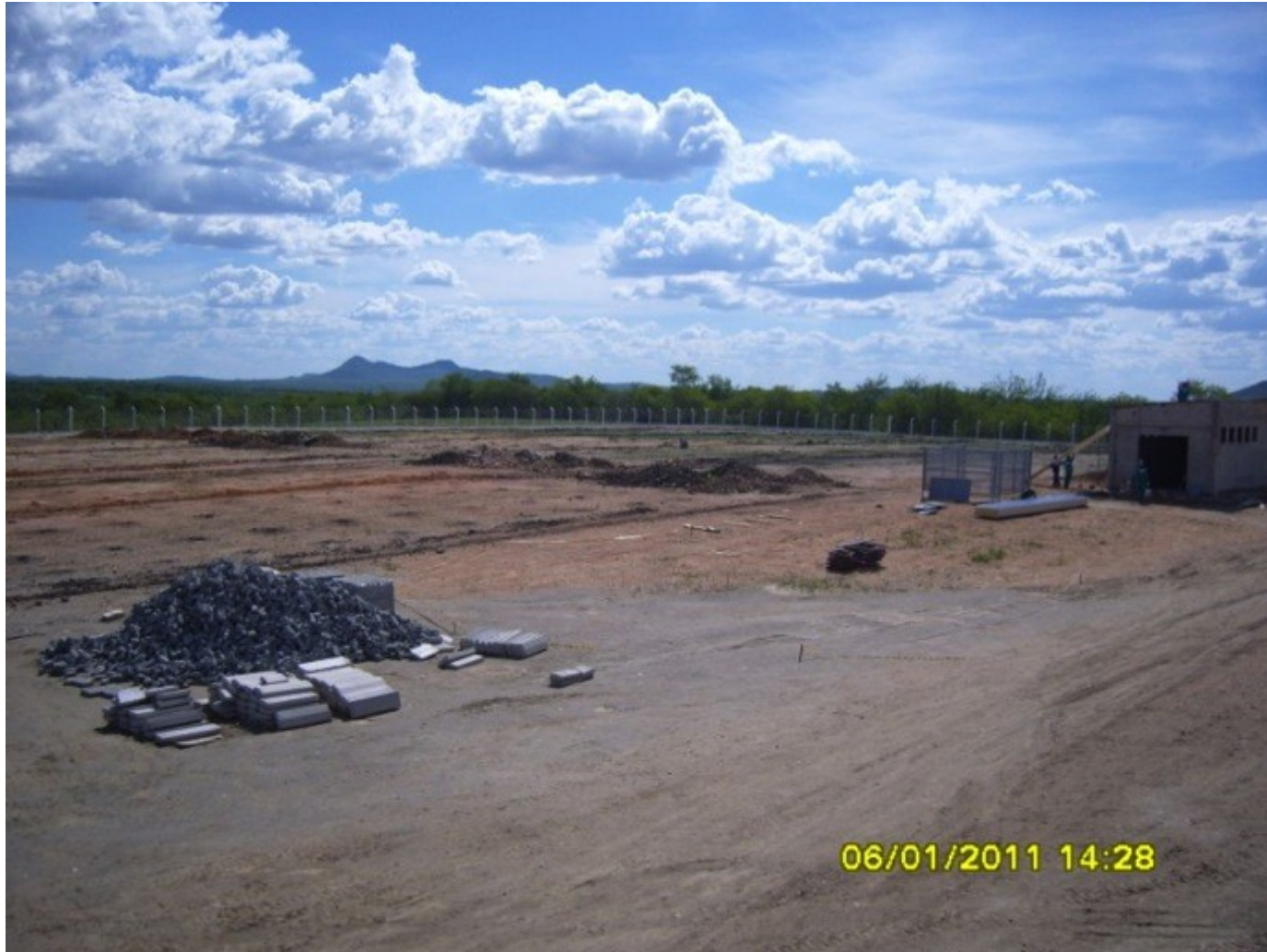
Dia 06-01-2010: Área dos painéis e Sala dos inversores
