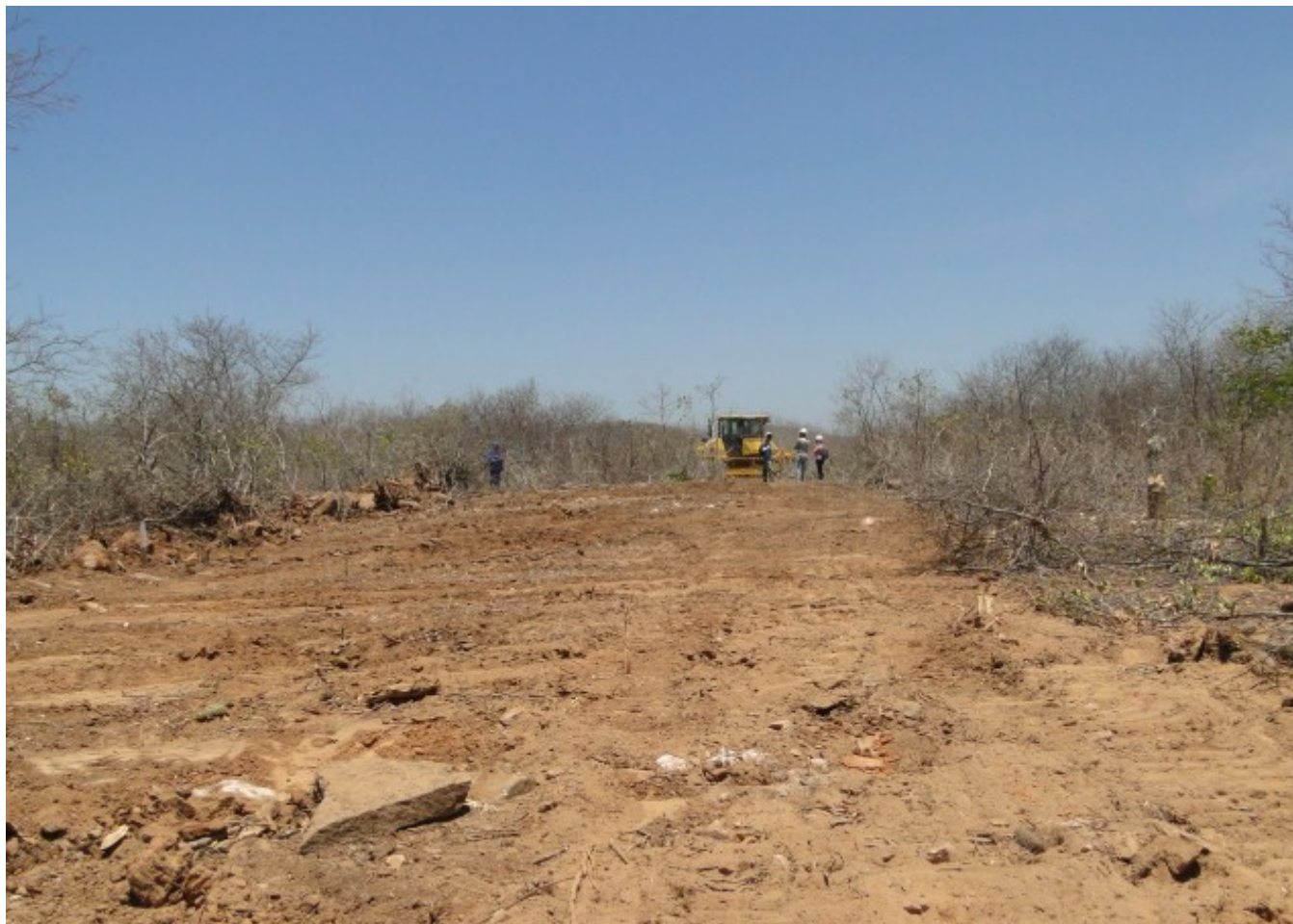
Dia 29- Set: Andamento do trabalho de supressão vegetal mecanizada da área destinada à Usina Solar (fase 1MW).
