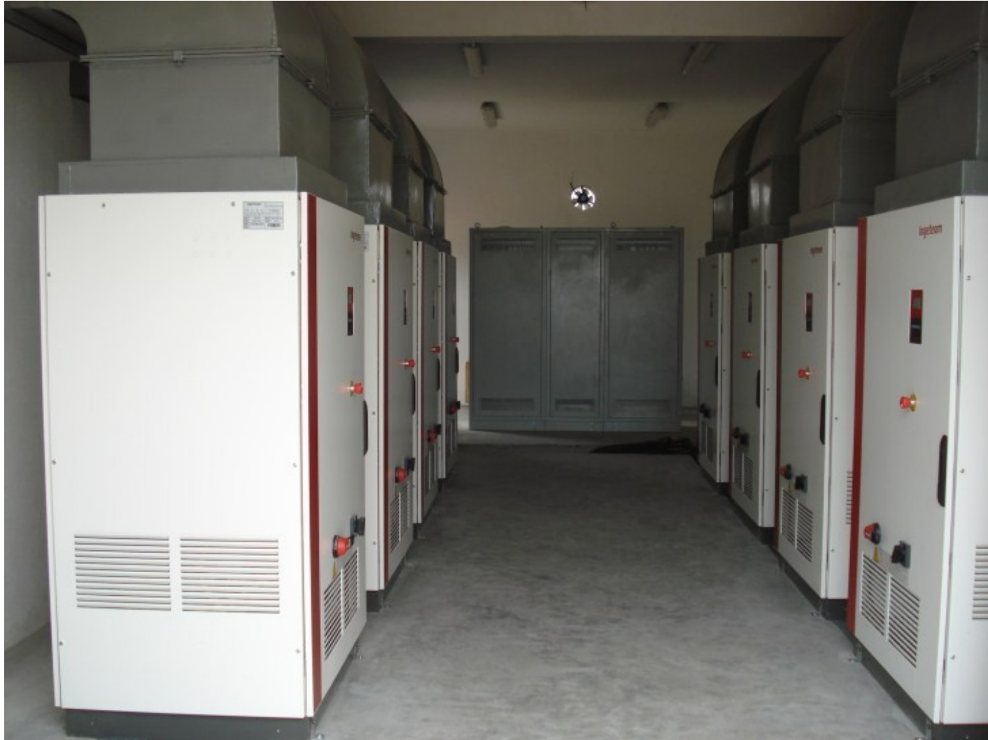
Dia 17- 02 - 2011: Inversores Instalados
